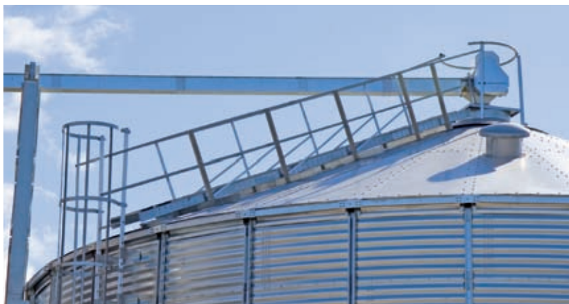
Drabina dachowa wyposażona w stopnie i poręcze.
