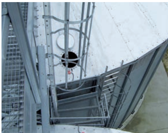
Pomost z podwójnym włazem rewizyjnym i drabiną do galerii.
